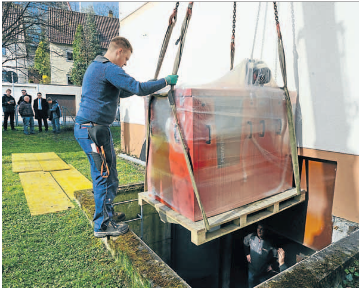
Dieses Mini-Blockheizkraftwerk versorgt 64 Wohnungen mit Wärme und momentan 42 dieser Wohnungen auch mit Strom. GEA-FOTO: USCHI PACHER
