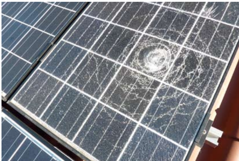
Nahaufnahme beschädigter Module. Foto: Envaris
